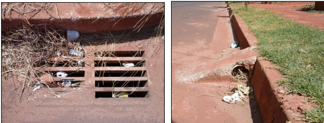
Figuras 3 e 4: Ituiutaba (MG): Resíduos sólidos encontrados em boca de lobo e guias em ruas localizadas no Conjunto Habitacional Nova Ituiutaba I, 2016. Autor: BARBOSA, J.O, 2016.
